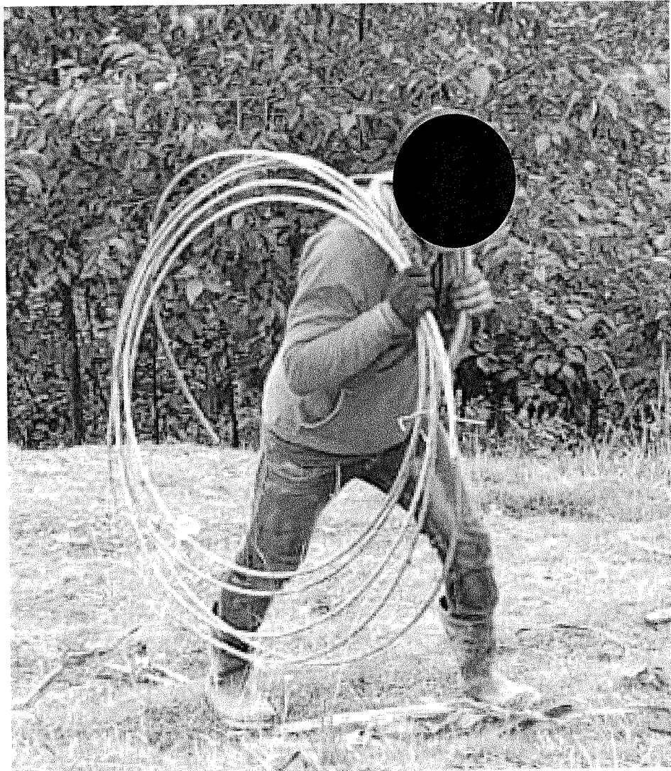
Personal sin uniforme ni equipo de protección
